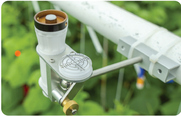
PAR sensor installed in the greenhouse.
